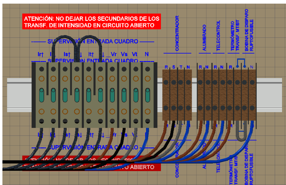
Figura 19 Borneros de conexiones con cubiertas de protección retiradas.
